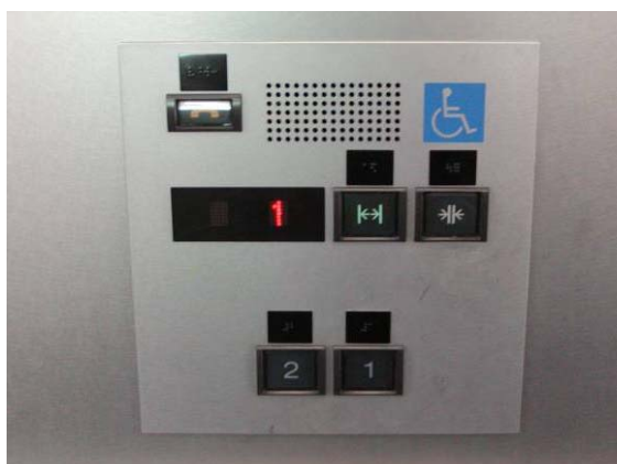
写真3-3-2 かご内側面の操作盤設置例
