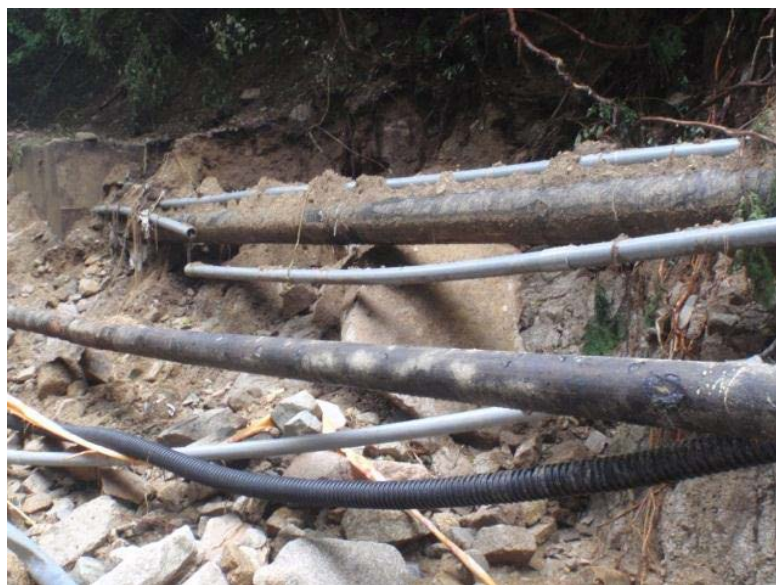
大雨による土砂崩れにより、管が露出 (H26.8奥山川ポンプ場付近)
