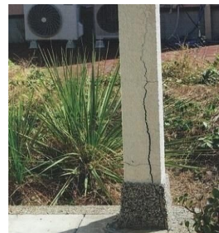
柱のひび割れ
