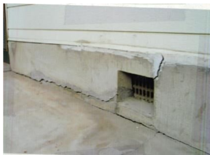
基礎のひび割れ
