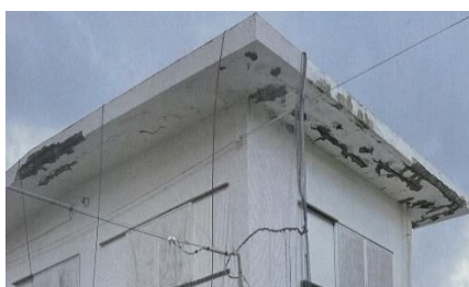
軒の剥落・露筋（RC造）
