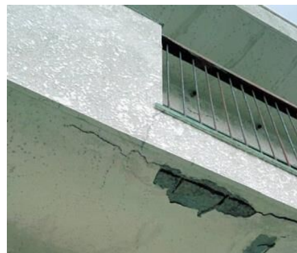
バルコニーの露筋（RC造）
