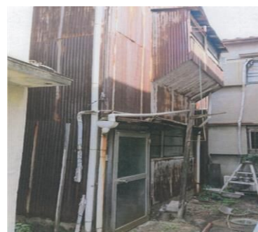
金属板の錆による腐朽
