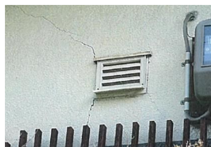
外壁のひび割れ
