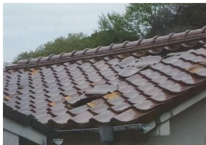
屋根瓦の剥落・ずれ
