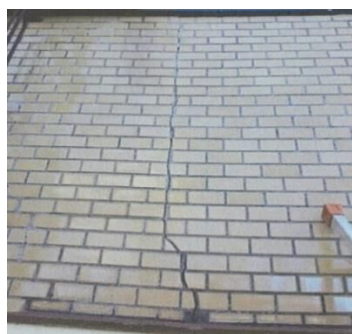
外壁タイルのひび割れ
