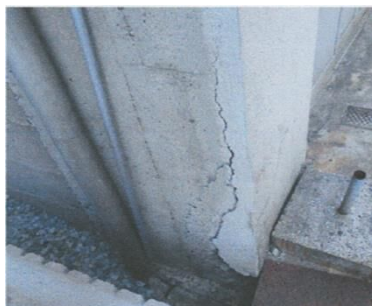
柱のひび割れ（RC造）
