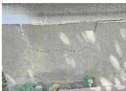
基礎のひび割れ
