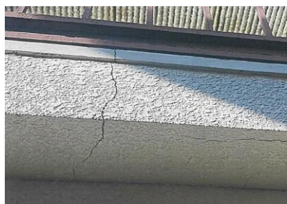
バルコニー軒先のひび割れ
