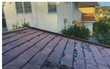
屋根材の腐朽（石綿セメント板）
