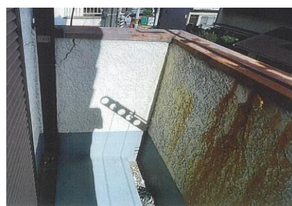
バルコニー腰壁のひび割れ・腐食
