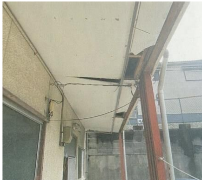
外廊下天井の剥落
