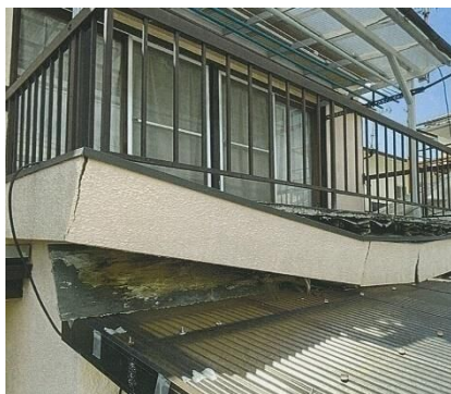
バルコニーの破損
