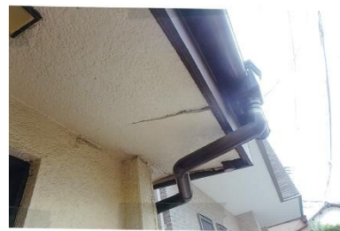
軒天井材のひび割れ
