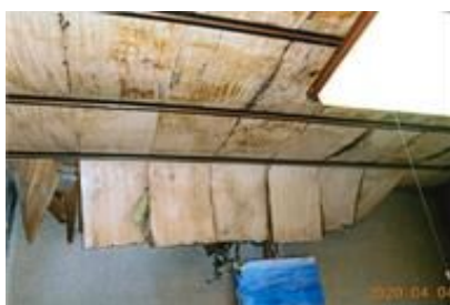
屋根破損による室内状況
