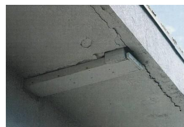
軒天井のひび割れ（軽量鉄骨造）
