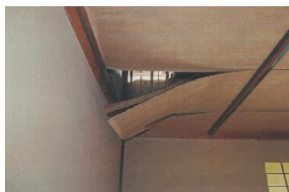
外壁破損による室内状況
