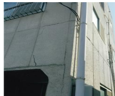
外壁（ALC板）の ひび割れ（鉄骨造）
