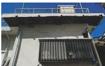
軒天井材の腐食落下（軽量鉄骨造）
