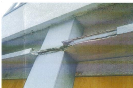
外壁の剥落（RC造）
