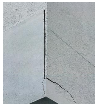
外壁のひび割れ
