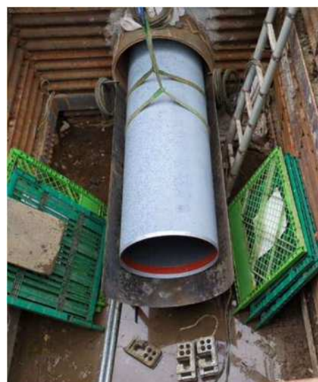
配水管更新工事（ダウンサイジング） （既設管φ900内にφ700新設管を挿入）
