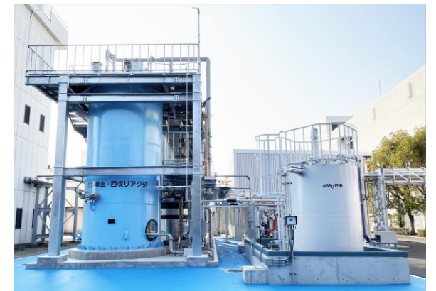
玉津処理場 リン回収設備 (市内2基目)
