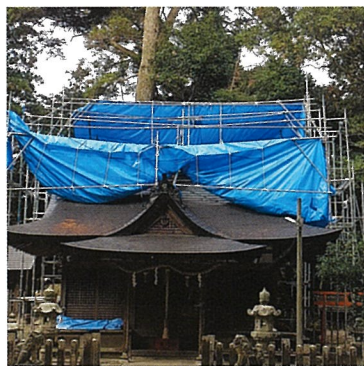
倒木により屋根部分が損傷
