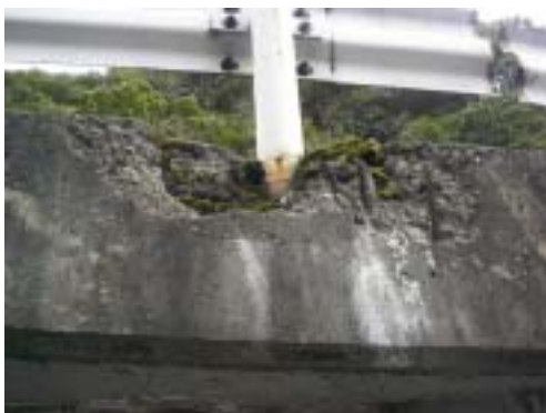
RC 地覆部の劣化の激しい箇所
