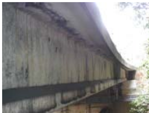
その他の劣化状況
