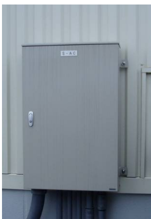
分電盤（空調機用開閉器箱）
