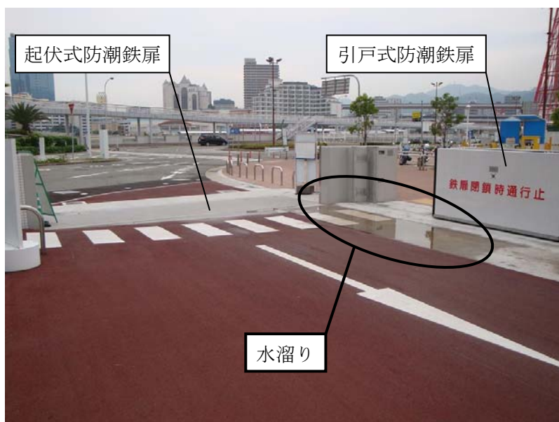
水溜りの状況写真
