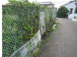
金網による応急措置の状況
