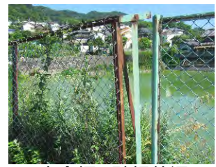
安全柵の破損状況
