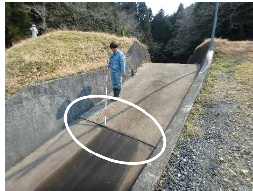
放水路部 漏水
