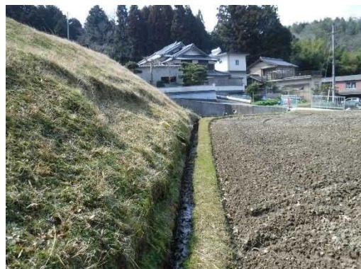
後法 はらみだし及び陥没
