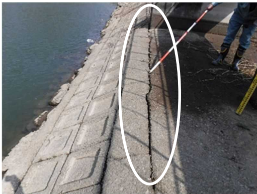
洪水吐流入部 ひび割れ
