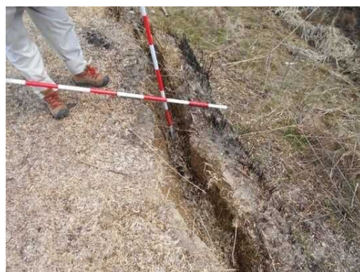
堤頂 ひび割れ
