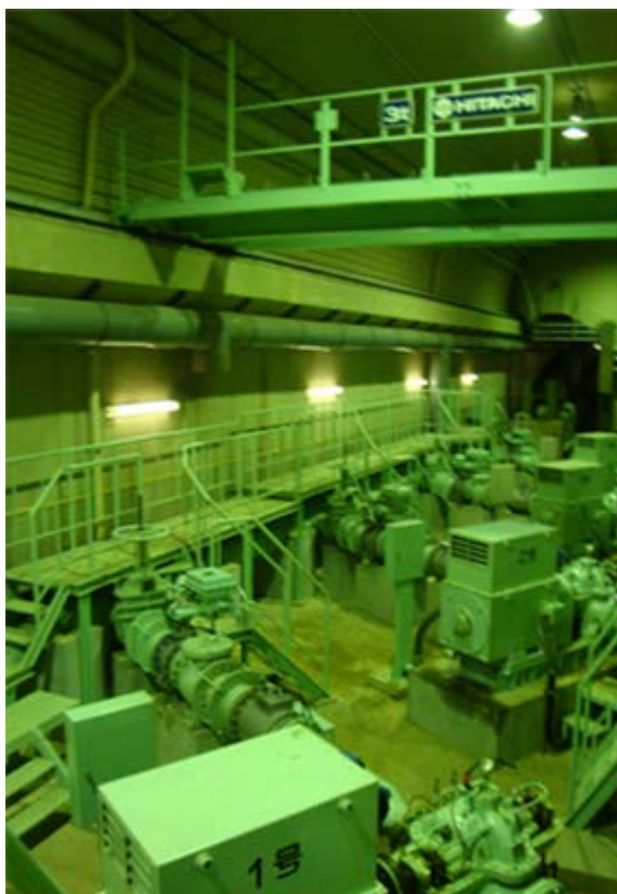
坑内ポンプ設備
