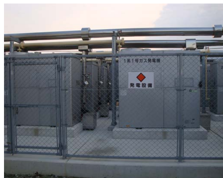
バイオガス発電設備
