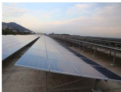
太陽光発電設備
