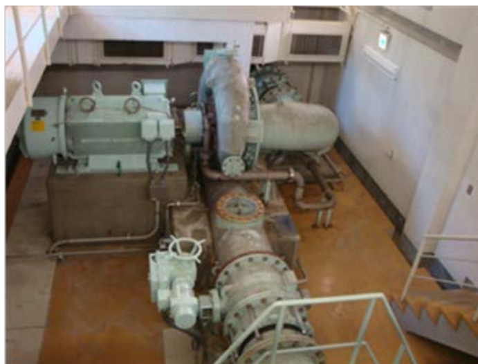
小水力発電設備
