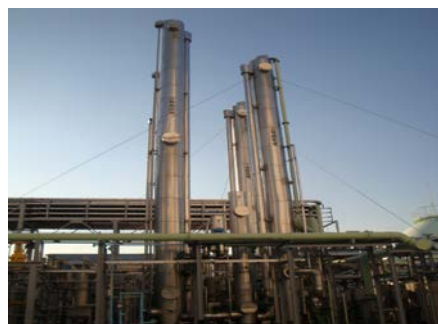
バイオガス設備 (精製設備)
