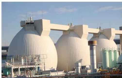
バイオガス設備 (消化タンク)
