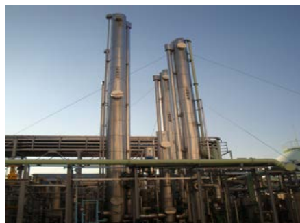
バイオガス設備 (精製設備)
