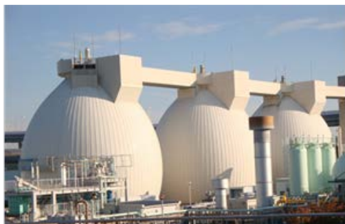
バイオガス設備 (消化タンク)
