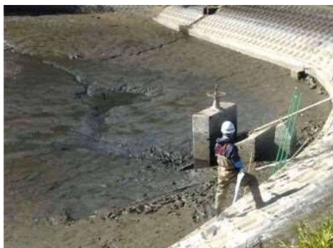
泥土堆積状況(かいぼり実施前)
