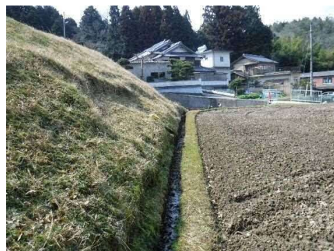
後法 はらみだし及び陥没
