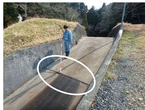
放水路部 漏水
