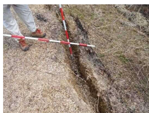
堤頂 ひび割れ
