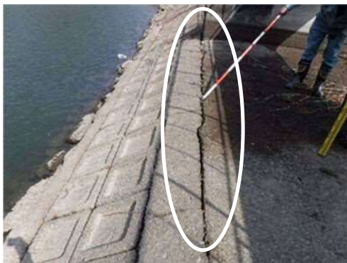
洪水吐流入部 ひび割れ
