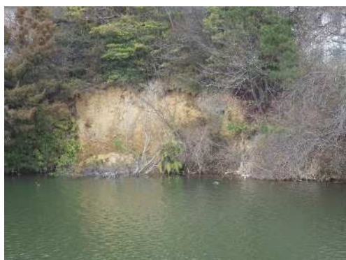
ため池周囲 土砂崩壊
