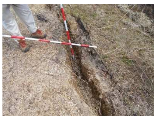
堤頂 ひび割れ
