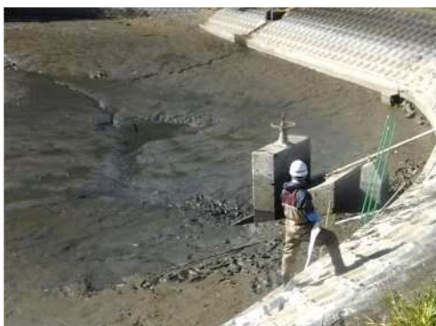
泥土堆積状況(かいぼり実施前)
