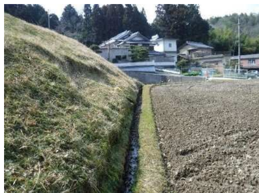
後法 はらみだし及び陥没
