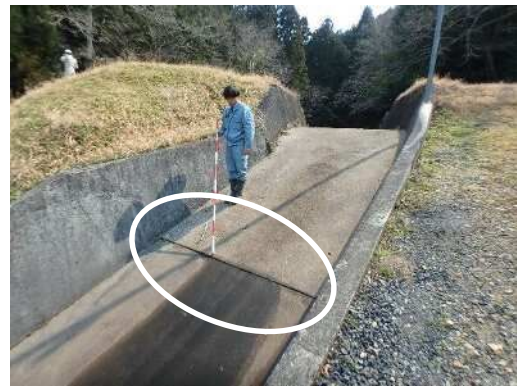
放水路部 漏水
