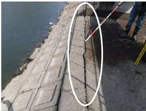
洪水吐流入部 ひび割れ
