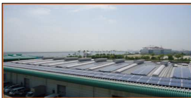
図 19 臨海部の屋根上太陽光発電設備
