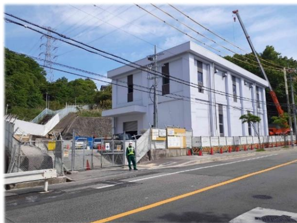
【花山ポンプ場】
