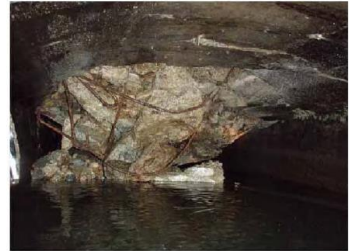
広島県送水トンネル崩落事故
