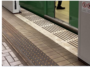
▲隙間・段差解消前
