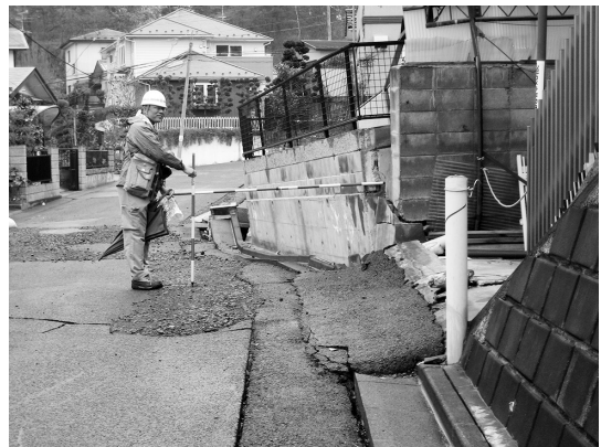
写真－４ 2011年東日本大震災による宅地の被害
