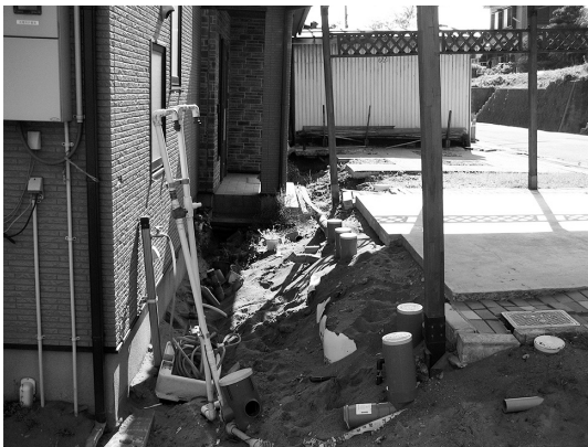
写真－３ 2007年中越沖地震による宅地の被害
