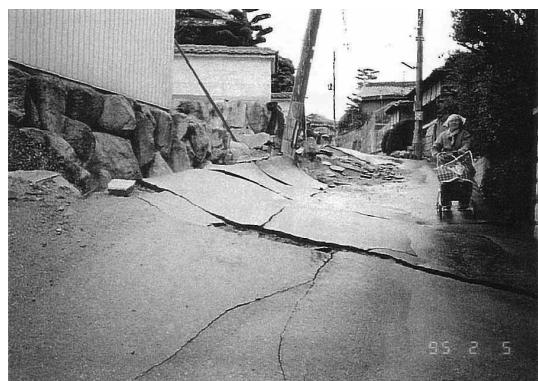
写真-1 1995年阪神・淡路大震災による宅地の被害
